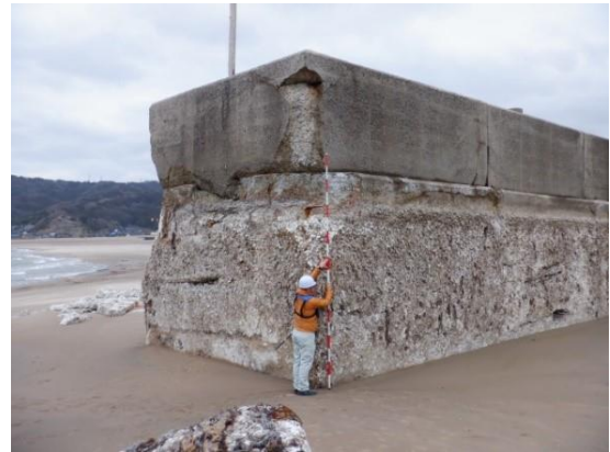
沿岸部の被災状況の確認（2024 年 3 月）
