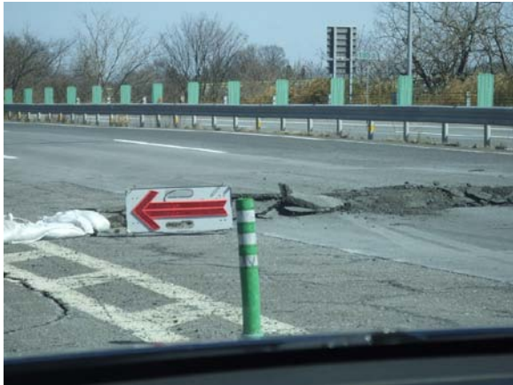
写真1 東北自動車道における路面の亀裂状況
